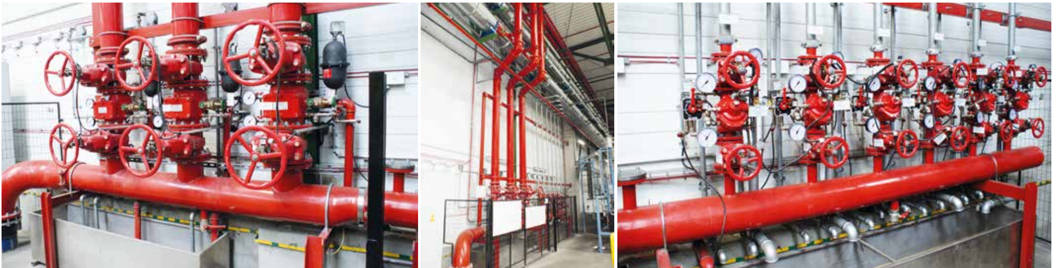
Systemy przeciwpożarowe Minimax chronią ludzi, urządzenia i obiekty we wszystkich środowiskach, gdzie istnieje ryzyko pożaru. Firma świadczy również usługi dla naszej branży, oferując rozwiązania dla ochrony przeciwpożarowej na wszystkich etapach obróbki drewna, maszyn oraz obszarów peryferyjnych związanych z zakładem. Fot. Piotr Kmieciak
