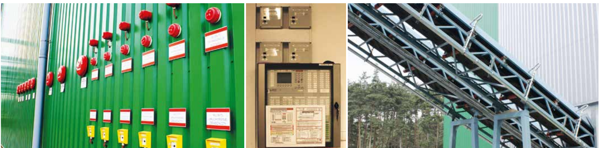
Zakład dodatkowo zabezpieczony został systemem sygnalizacji pożaru, wyposażonym w przemysłowe czujki wykrywające pożar w bardzo wczesnej fazie. System po wykryciu pożaru informuje zakładową straż pożarną oraz w miejscu niebezpiecznym generuje sygnał świetlny-dźwiękowy. Fot. Piotr Kmieciak
