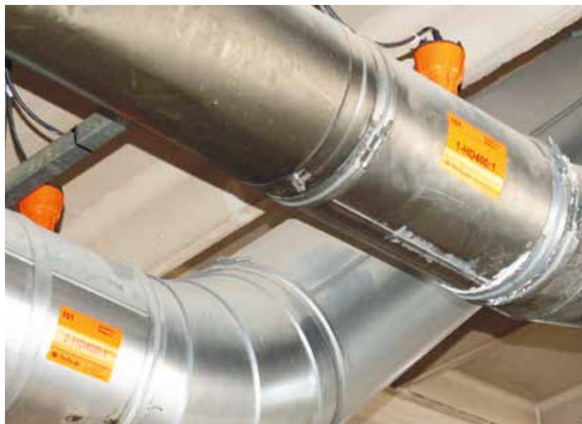
Każda z zainstalowanych stref składa się z detektora HD400 oraz trzech dysz gaśniczych.
