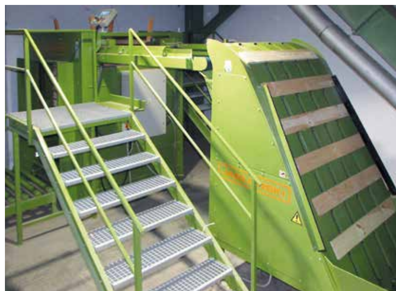
Jedno z dwóch stanowisk operatora sztaplarki. Fot. ZM Jabłoński
