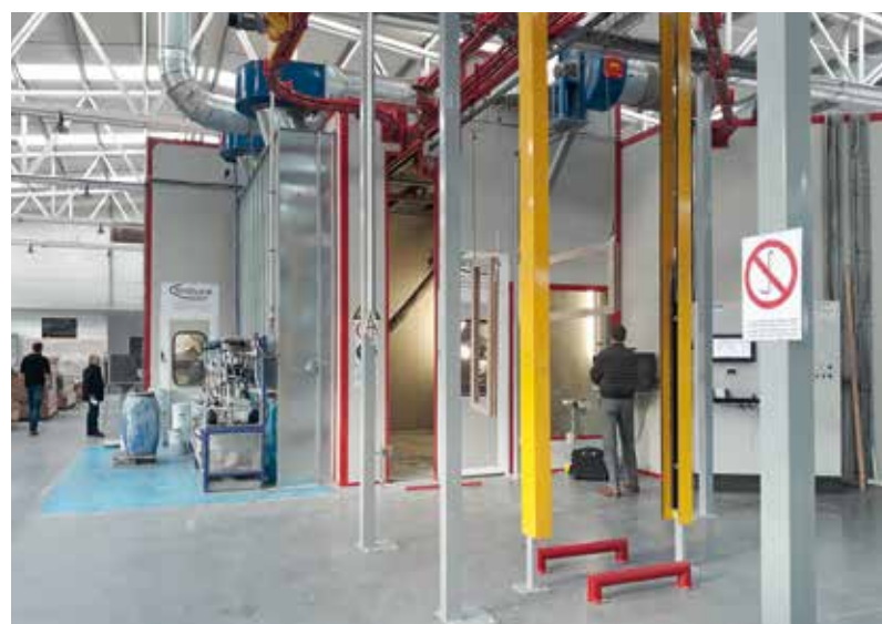
Nowa linia lakiernicza w firmie Bertrand została zaprojektowana w ten sposób, by gwarantować powtarzalność doskonałego efektu końcowego w produkcji okien.
