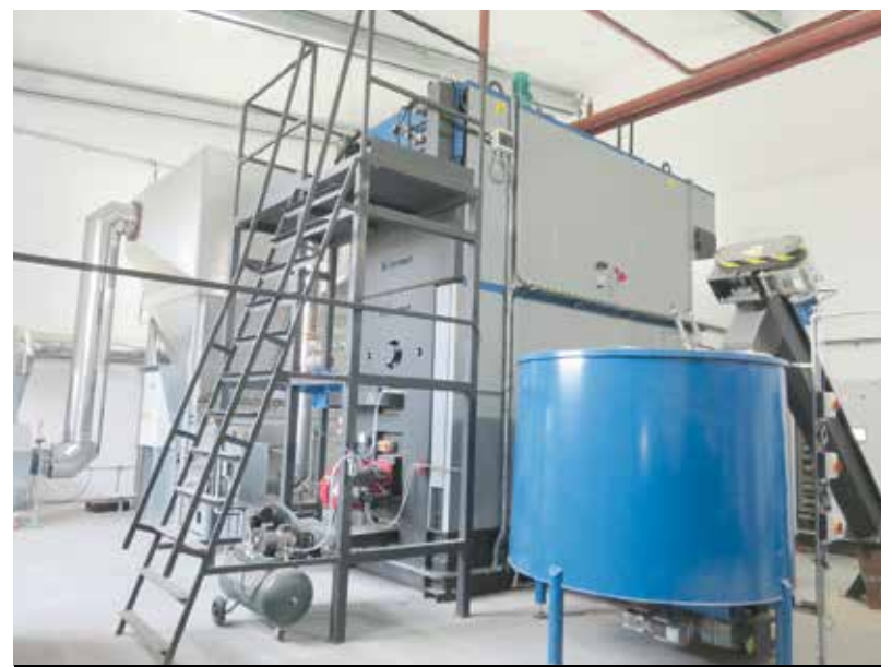
Stałym komponentem instalacji jest system automatycznego podawania paliwa, umożliwiający dostosowanie strumienia masy materiału opałowego do aktualnego zapotrzebowania. Fot. Intermet Kotły Grzewcze
